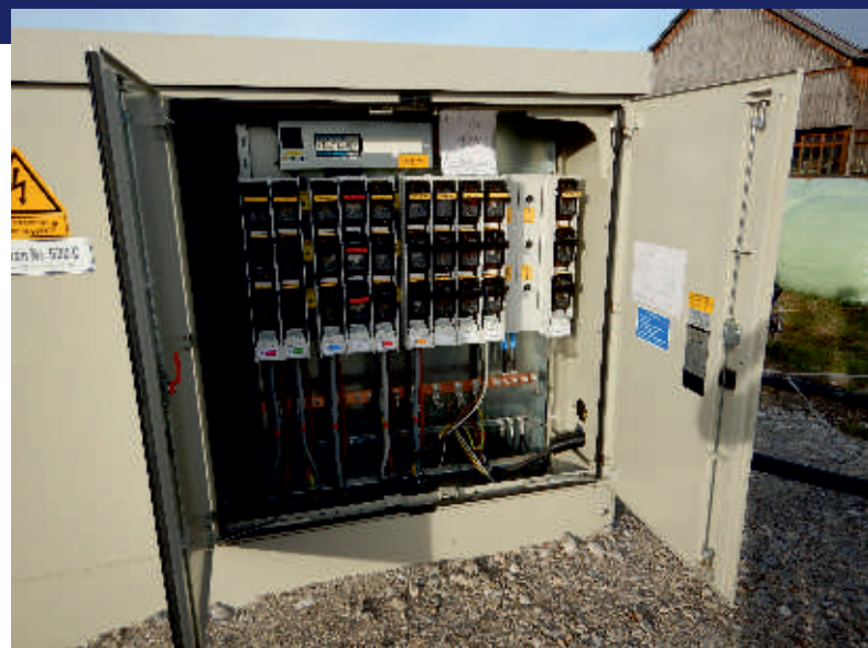
Schaltstation in Tannenberg
