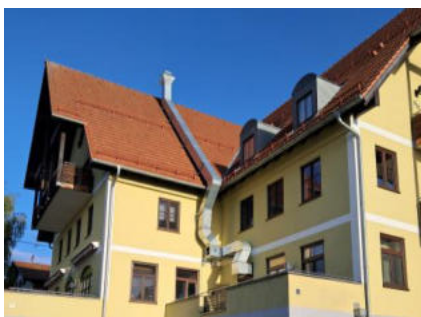
Abluft- und Zuluftanlage am Roatherhaus.
